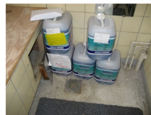
X: Opslag nabij afvoerput!
